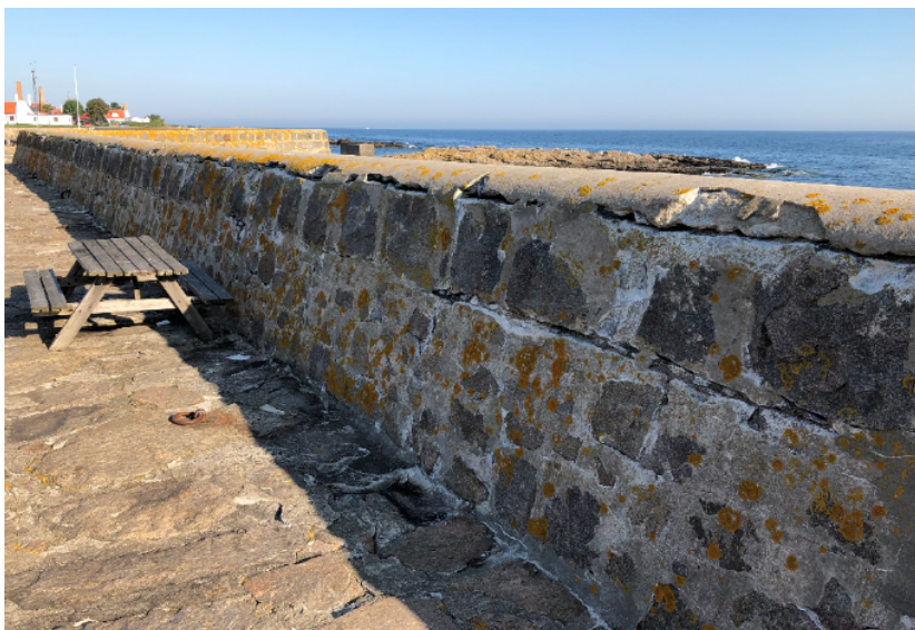
Billede 1: Strækning med behov for sikring via regulært fugearbejde.
