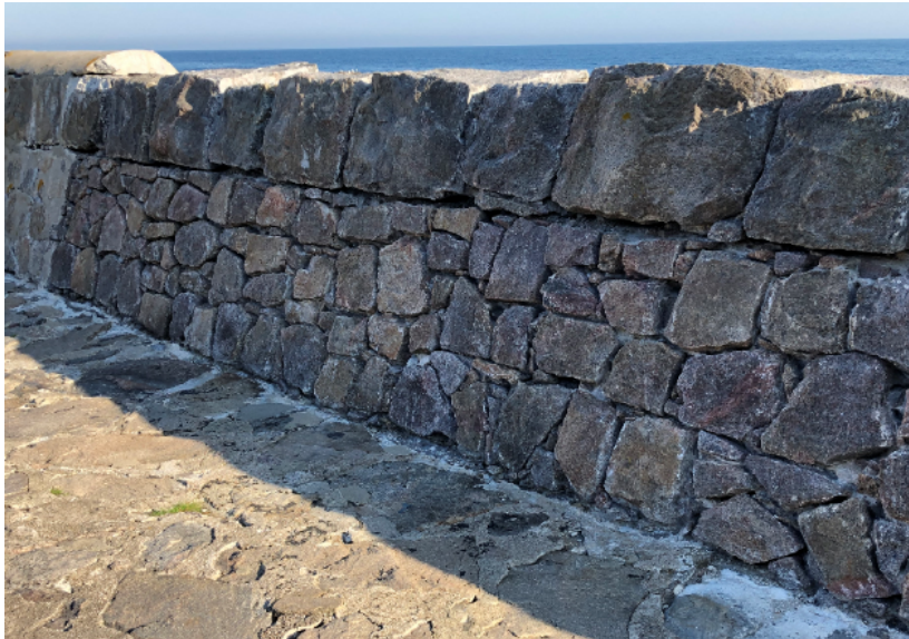
Billede 2: Strækning hvor den inderste del af bølgeskærm er blotlagt, herunder er den runde kappe på toppen fjernet. Dette arbejde er udført under bevillingen, men mangler afsluttende fugning.
